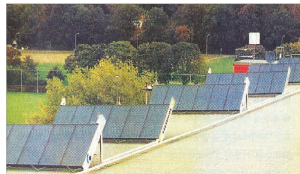
드라이잠 축구경기장 태양광발전장치
