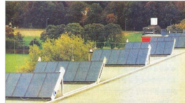
드라이잠 축구경기장 태양광발전장치
