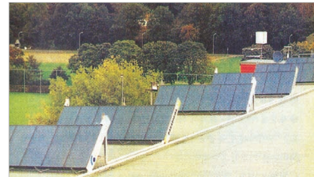
드라이잠 축구경기장 태양광발전장치
