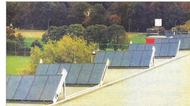
드라이잠 축구경기장 태양광발전장치
