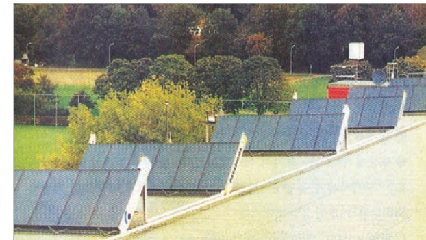
드라이잠 축구경기장 태양광발전장치
