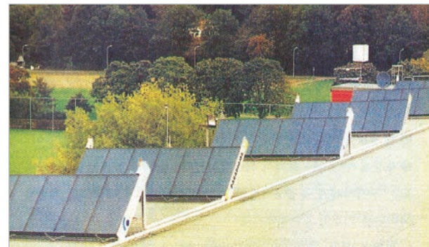
드라이잠 축구경기장 태양광발전장치
