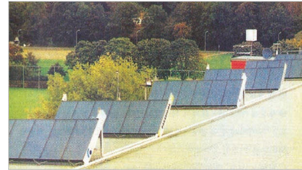
드라이잠 축구경기장 태양광발전장치
