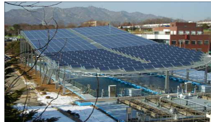
Xbc & Y 맑은물 사업소에 설치된 태양광 발전소
