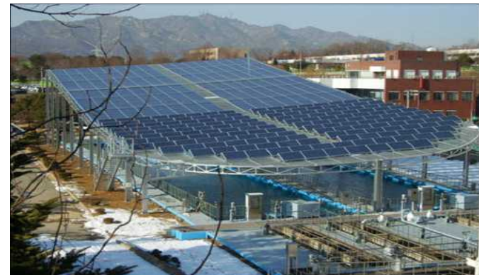
<그림 22> 맑은물 사업소에 설치된 태양광 발전소
