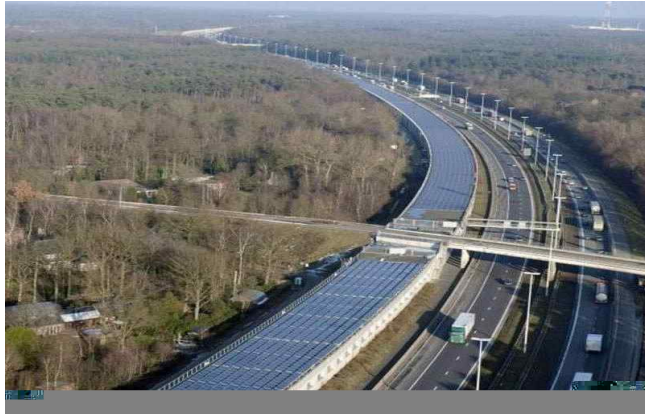
<그림 9> 벨기에의 터널에 설치된 태양광 터널
