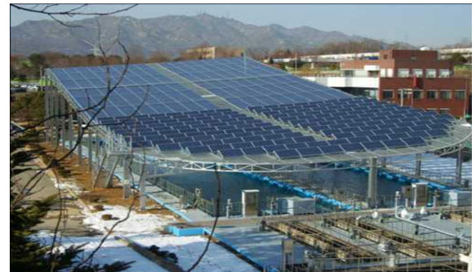
<그림 22> 맑은물 사업소에 설치된 태양광 발전소
