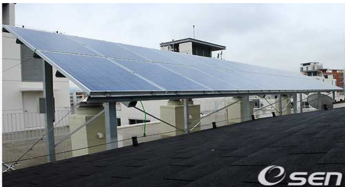
대구 세계육상선수권대회 선수촌 태양광시설물
