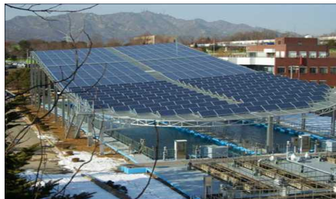
<그림 22> 맑은물 사업소에 설치된 태양광 발전소
