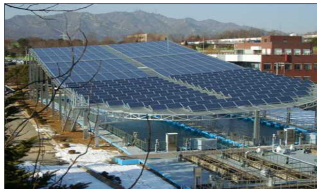
<그림 22> 맑은물 사업소에 설치된 태양광 발전소
