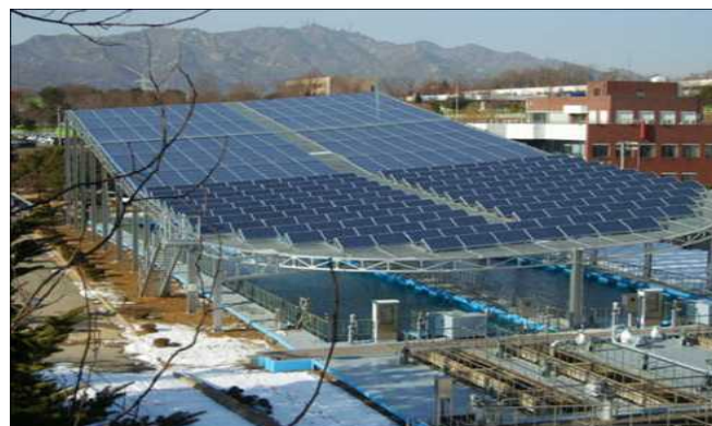
<그림 22> 맑은물 사업소에 설치된 태양광 발전소
