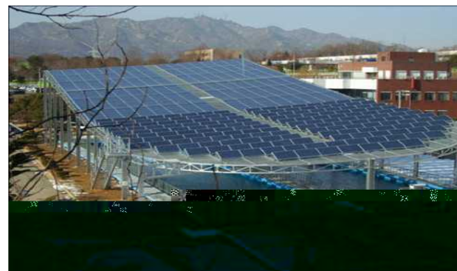
<그림 22> 맑은물 사업소에 설치된 태양광 발전소
