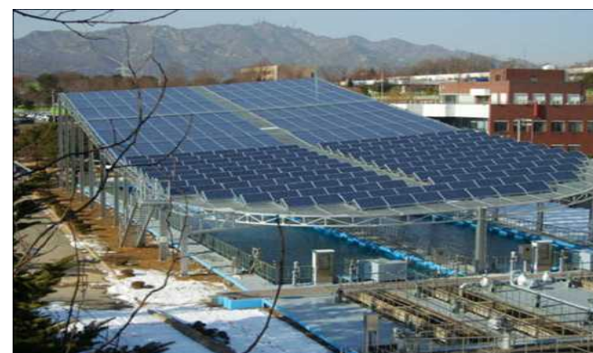
<그림 22> 맑은물 사업소에 설치된 태양광 발전소
