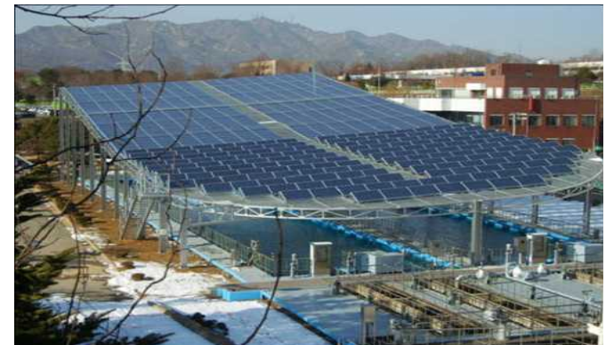
<그림 22> 맑은물 사업소에 설치된 태양광 발전소
