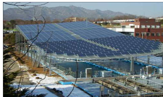
<그림 22> 맑은물 사업소에 설치된 태양광 발전소
