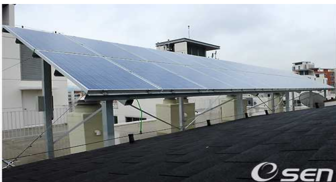
<그 20> 대구 세계육상선수권대회 선수촌 태양광시설물
