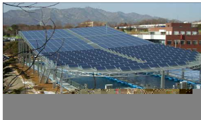
<그림 22> 맑은물 사업소에 설치된 태양광 발전소
