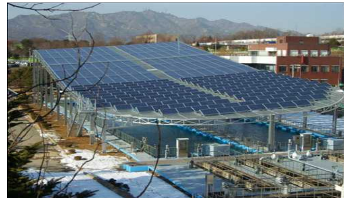
<그림 22> 맑은물 사업소에 설치된 태양광 발전소
