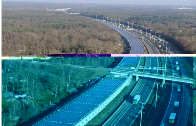
<그림 9> 벨기에의 터널에 설치된 태양광 터널
