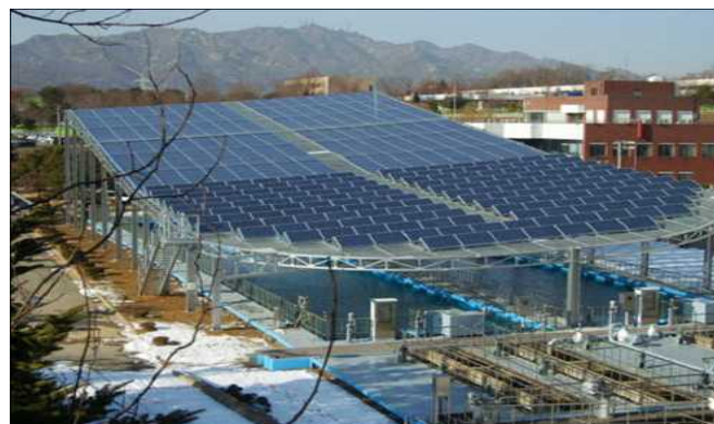
<그림 22> 맑은물 사업소에 설치된 태양광 발전소
